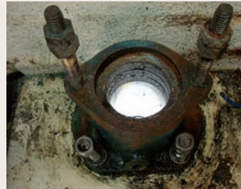
Prensaestopa antes de ser desmontado.
